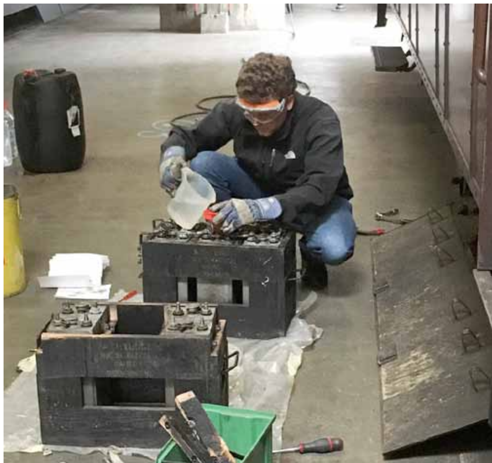
Die Batterien werden wieder gefüllt
