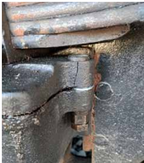
Riss am Achslagerdeckel
